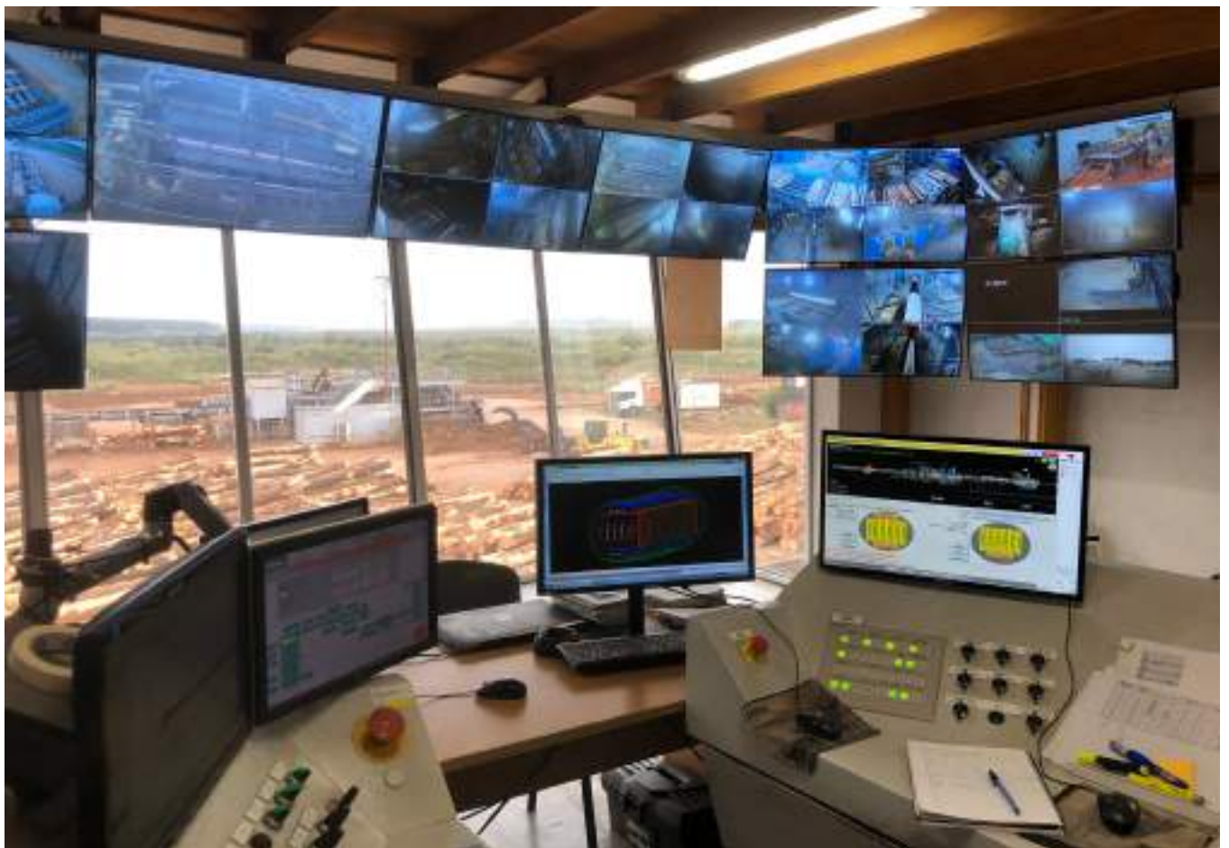
Figura 13. Sala de control planta Arboreal. Fuente: Propia
